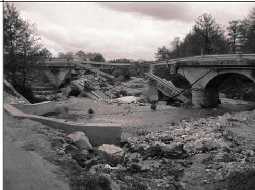
Villanova Alluvione dic. 2004 - Ponte SS 389
