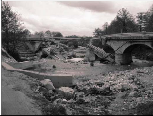
Villanova Alluvione dic. 2004 - Ponte SS 389
